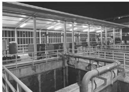
โรงบำบัดน้ำเสีย
