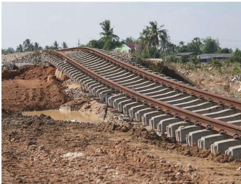
☞ เร่งซ่อมราง - สภาพรางรถไฟสายใต้ช่วงสถานีบ้านต้นโตน-สถานีชุมทางหาดใหญ่ จ.สงขลา ได้รับความเสียหายอย่างหนักจากน้ำท่วมใหญ่ การรถไฟฯเร่งซ่อมแซมให้กลับมาใช้การได้ภายในวันที่ 7 ธ.ค.นี้
