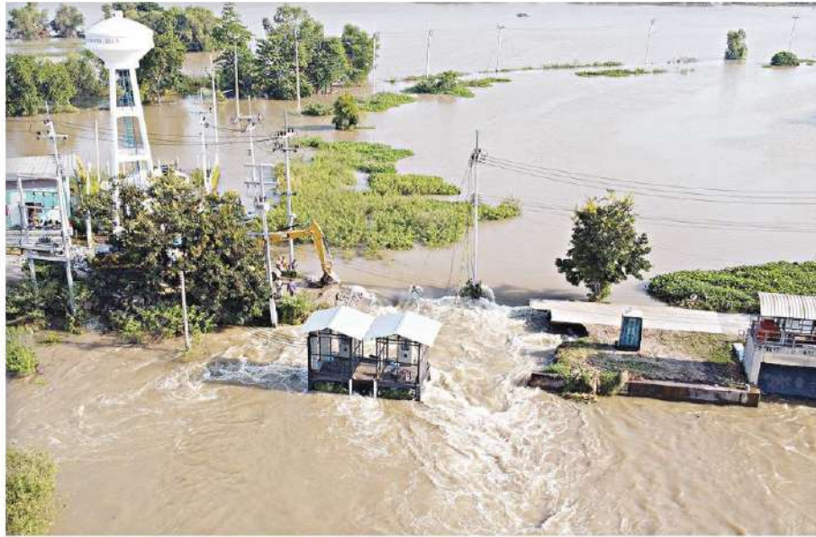
▲พังทลาย...สภาพคันคลองชลประทานใกล้ประตูระบายน้ำเจ้าเจ็ด หมู่ 7 ต.รางจระเข้ อ.เสนา จ.พระนครศรีอยุธยา ถูกกระแสน้ำกัดเซาะขาดเป็นช่องโหว่มวลน้ำไหลทะลักท่วมหลายพื้นที่ด้านล่าง
